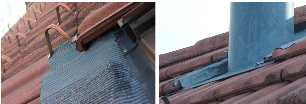
Abbildung 11: Mit Walzblei verwahrte Anschlüsse bei Dachfenster und Schornstein (Bilder: R. Taverna).
